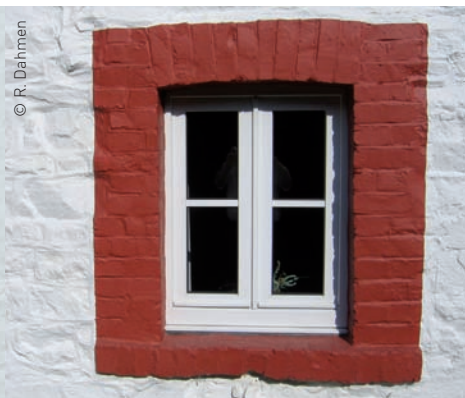
Die Verglasung des Sprossenfensters wirkt durch den breiten Rahmen zu klein. Diese Unterteilung ist nicht für kleine Fensteröffnungen geeignet
