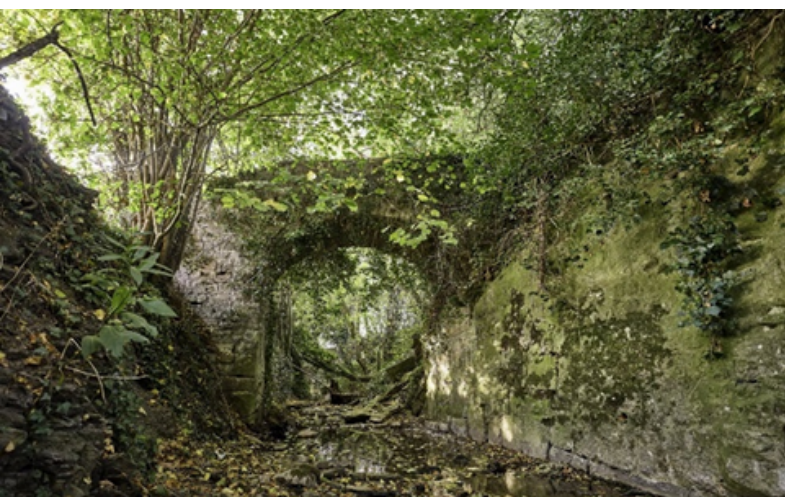
Hohe Brücke: Kalksteinbrücke mit einer lichten Höhe von 6 m wurde im 18 Jhdt. errichtet.
